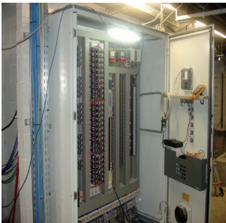
La centrale di controllo automatica ha il compito di processare in tempo reale le condizioni dell'ambiente e gestire conseguentemente il passaggio da ventilazione permanente a EFFC
